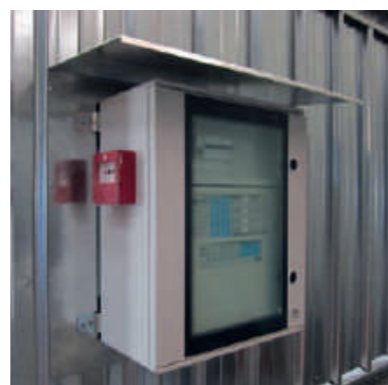
CENTRALINA DI UN IMPIANTO ANTINCENDIO
