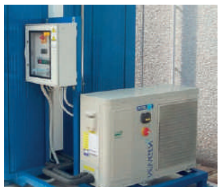
UNITA' MOTOCONDENSANTE ESTERNA CON QUADRO DI COMANDO
