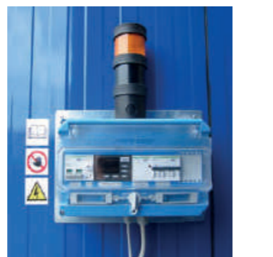
CENTRALINA DI COMANDO IMPIANTO ELETTRICO
