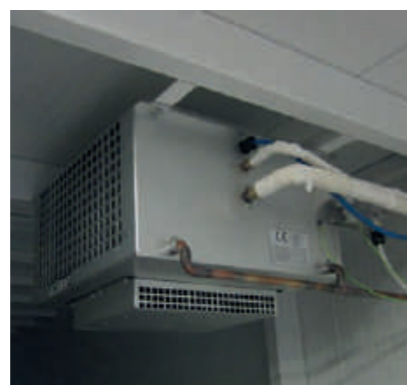
AEROEVAPORATORE INTERNO IMPIANTO DI CLIMATIZZAZIONE
