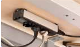
Toma de conexiones
